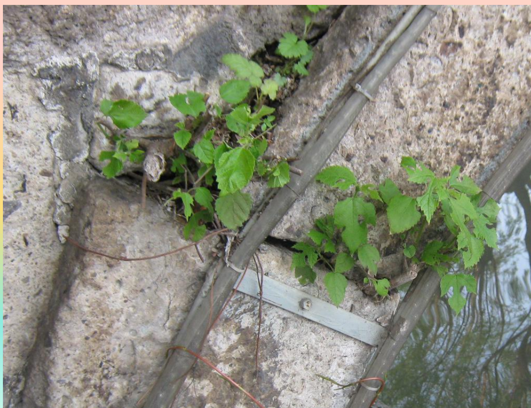
宝珠桥龙筋石突出拱圈部分
